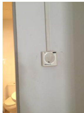
Figura 6. Termòstats de climatització
