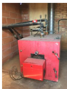
Figura 4. Caldera de gasoil
