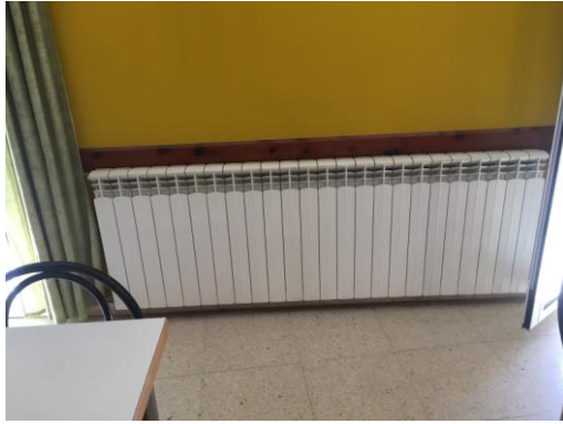
Figura 3. Unitats terminals radiadors
