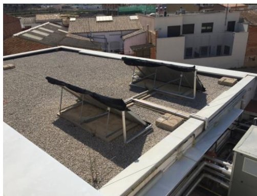
Figura 6. Instal·lació solar tèrmica
