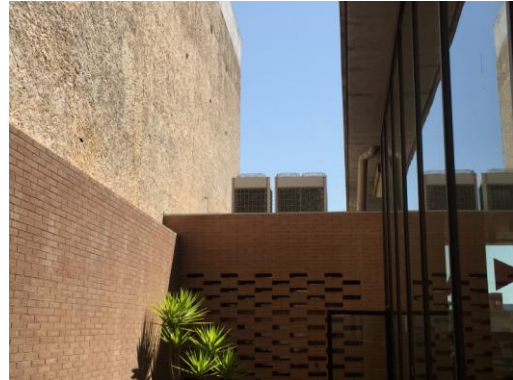
Figura 4. Bombes de calor aire -aigua
