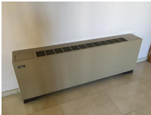
Figura 7. Unitats terminals fan-coils
