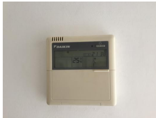
Figura 6. Termòstat de climatització
