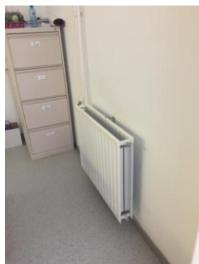
Figura 3. Unitats terminals radiadors
